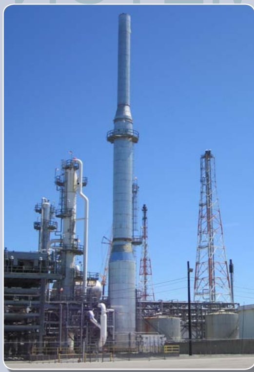
Вертикальная печь дожига хвостовых газов установки серы
