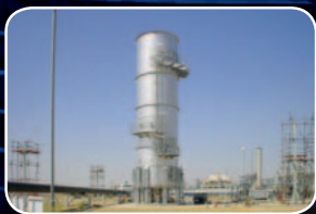
Вертикальная печь дожига хвостовых газов установки серы
