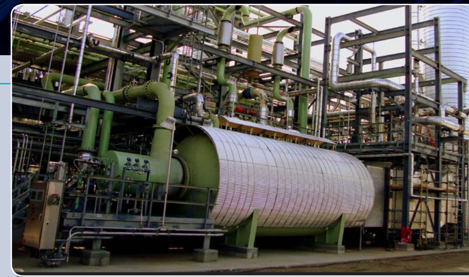
Термический окислитель установки серы с водотрубным котлом-утилизатором тепла.
